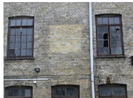
Renovering af Porcelæns-haven . Afrensning af prøvefelter på teglsten før afrensning til efterfølgende filts
