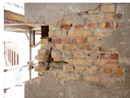
Efter sandblæsning, nedhugges murværk for at blotlægge armeringsjern og bæringer til ny overfladebehandling mod korrosion.
